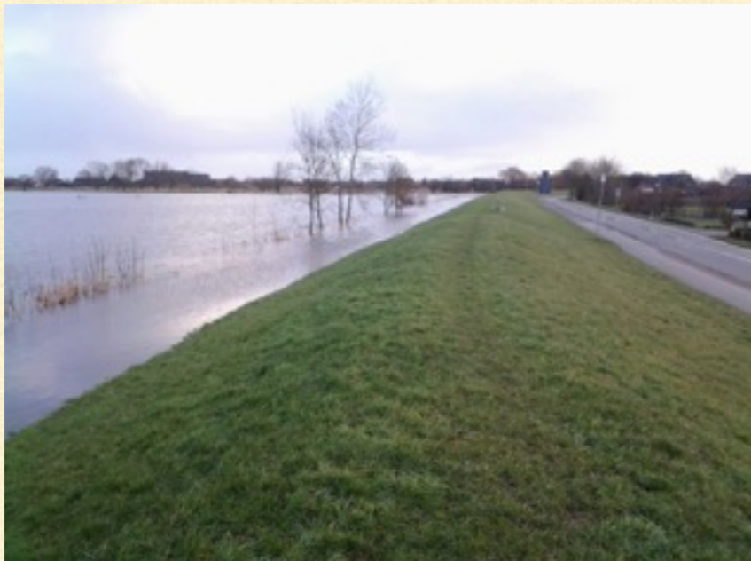
Die Überlaufschwelle schützt den weiteren Lühedeich
